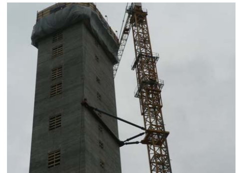
Bild 1 Treppenturm in Gleitbauweise. Der Turmdrehkran ist mit einer Klammer am Bauwerk befestigt.
