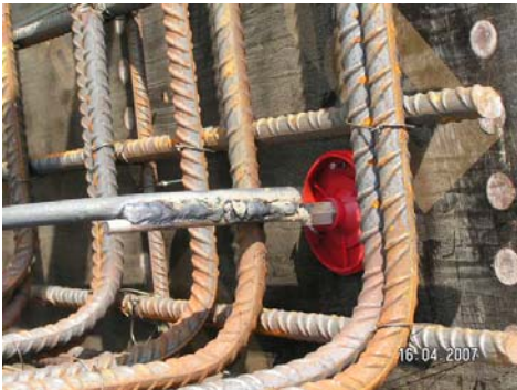
Bild 3 Erdungsrundstahl Ø 10mm mit Edelstahlerdungsplatte
