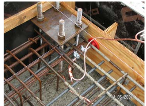
Bild 4 Anschluss Kupferdraht mit Erdungsplatte und Anschlussfahne
